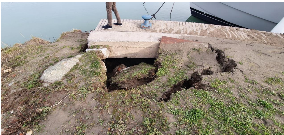
Foto 04 – danni a seguito dell'erosione
