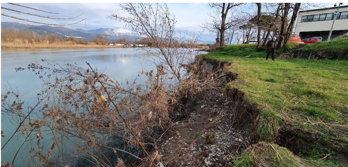
Foto 07 – sponda destra fenomeni di erosione
